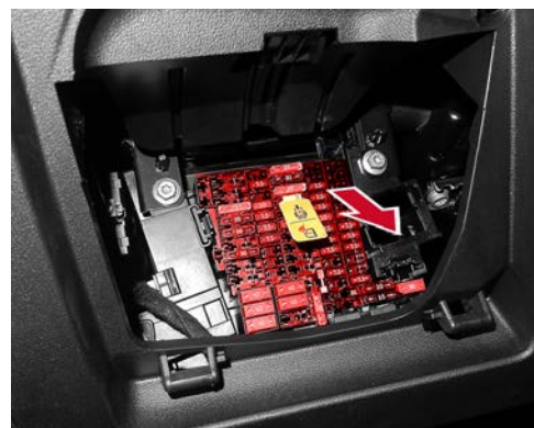
Punto de corte en el habitáculo, portafusibles en el tablero de instrumentos
